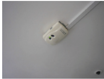
가스누설경보기의 탐지부가 설치된 사례
