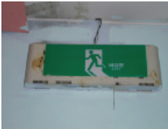
유도등이 부식되어 점등되지 않는 경우
