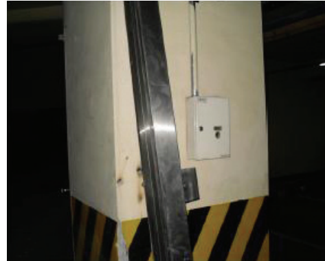
방화셔터 레일이 파손된 상태로 방치한 경우
