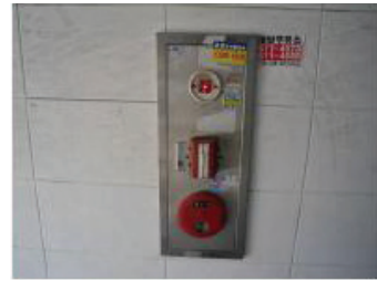
위치표시등의 파손을 방치한 경우
