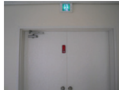
피난구 유도등이 올바르게 설치된 경우
