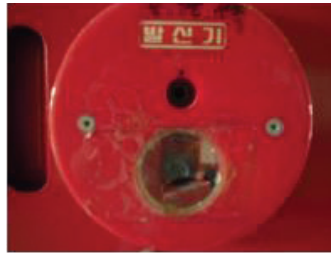
발신기의 파손을 방치한 경우
