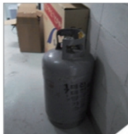
가스 저장용기 설치장소에 아무렇게나 방치
