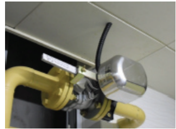
가스누설경보기의 차단밸브가 설치된 사례
