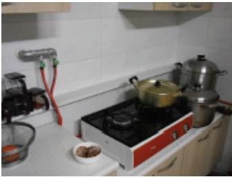
가스누설경보기가 미설치된 경우
